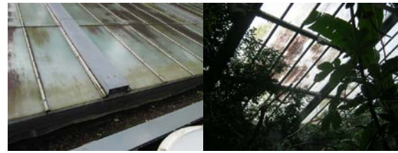
Abbildung 6: sichtbare Alterung / Veralgung der Dachverglasung Tropenhaus Quelle: BioClima (2014)
